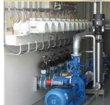
Система подачи химдобавок
