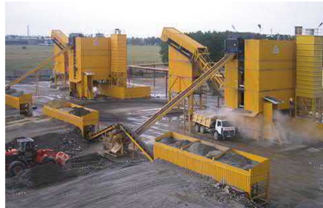
CSD 2500 – 2 установки на одной площадке в России
